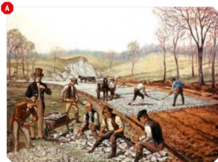
EMPIERREMENT D'UNE ROUTE SELON LA TECHNIQUE MACADAM EN 1823. Carl Rakeman, First American Macadam Road , États-Unis, 1823.
